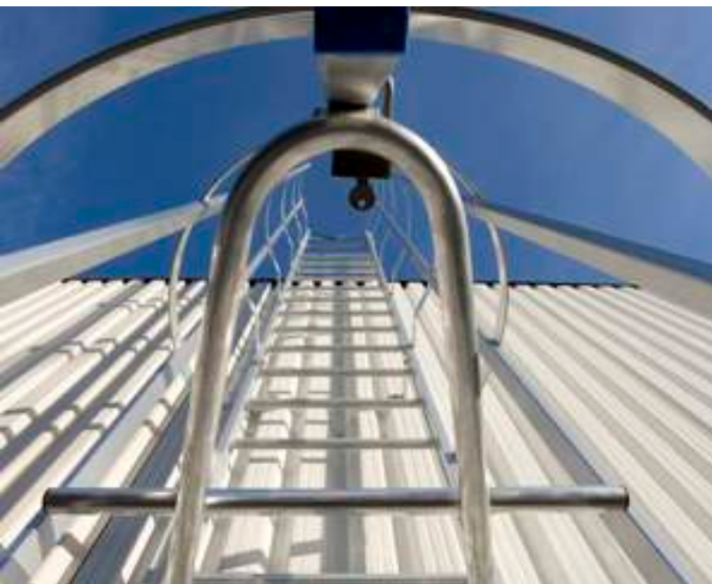
> Accès de sécurité échelle de secours
